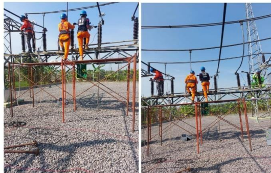
Gambar 9 Proses Perbaikan Anomali Hotspot
