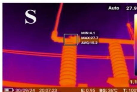
Gambar 10 Hasil Thermovisi setelah Perbaikan
