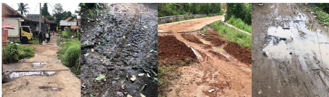
Gambar 1. Kondisi Infrastruktur jalan rusak di Dusun Cikuya, Desa Sindangsari Sumber: Dokumentasi lapangan, 2025
