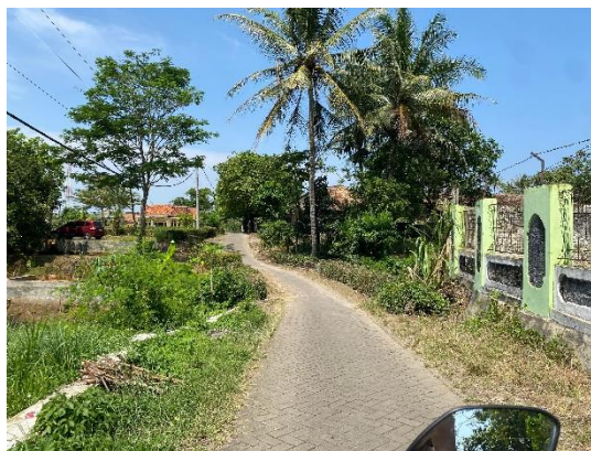
Gambar 2. Kondisi jalan paving block Desa Panyirapan
